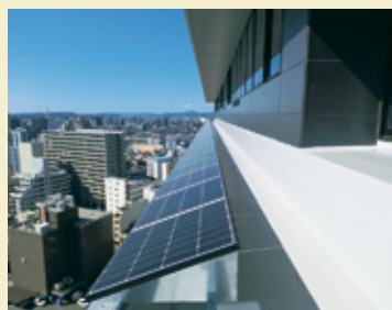
▲南面の庇に設置した太陽光パネル
