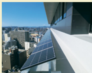
▲南面の庇に設置した太陽光パネル
