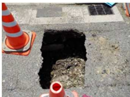
取付管破損による陥没
