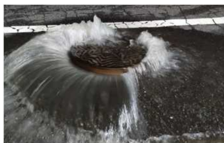
侵入水によるマンホール蓋の浮上
