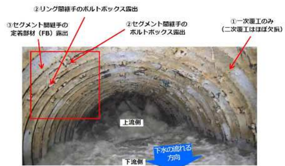
出典：八潮市で発生した道路陥没事故に関する原因究明委員会より資料抜粋
