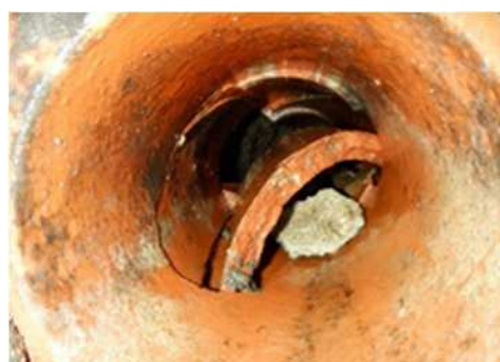
取付管の破損状況
