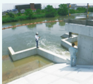
ポンプによる雨水吐き出しの様子
