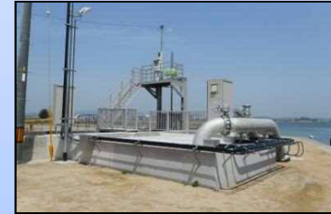
小串港排水機場
