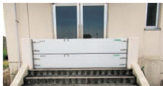
▲止水板設置例(浦安ポンプ場)
