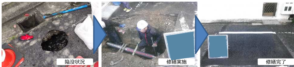
陥没および修繕状況（取付管の破損）
