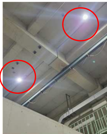
政津ポンプ場屋内灯LED化
