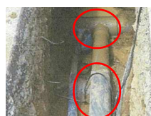
取付管破損箇所
