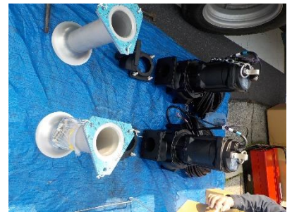
省エネ型ポンプに更新 約570kWh/年削減
