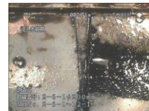
地下水の浸入あり
