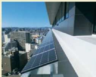
▲南面の庇に設置した太陽光パネル
