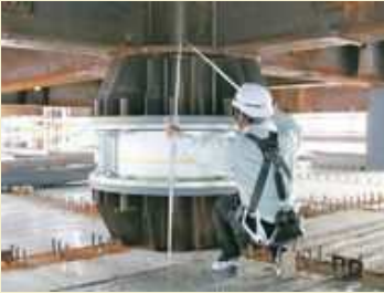
▲免震層に設置した免震装置 (令和6年9月時点)
