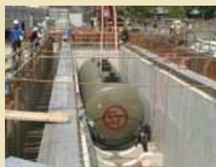
▲地下に設置された燃料タンク (5月時点)
