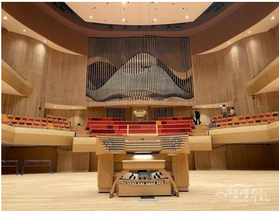
▲富川アートセンター大公演場内に設置したパイプオルガン
