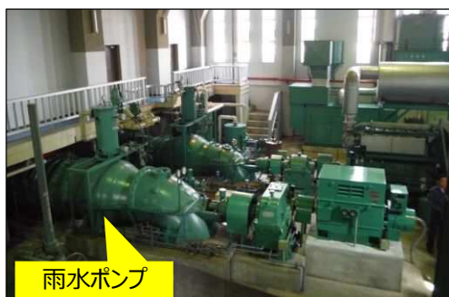
天瀬ポンプ場(昭和29年供用開始)
