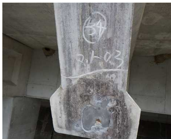
事例②主梁の鋼材露出
