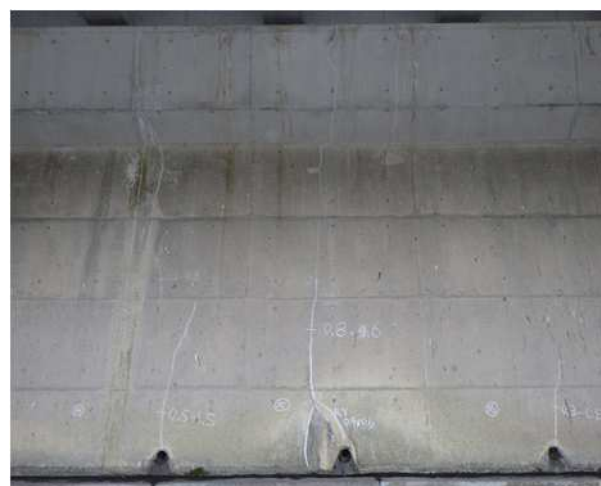
事例④山側受台のひびわれ、遊離石灰
