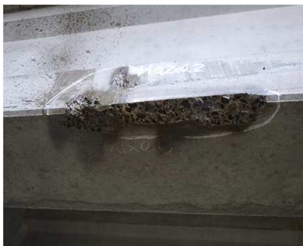
事例①主梁のはく離
