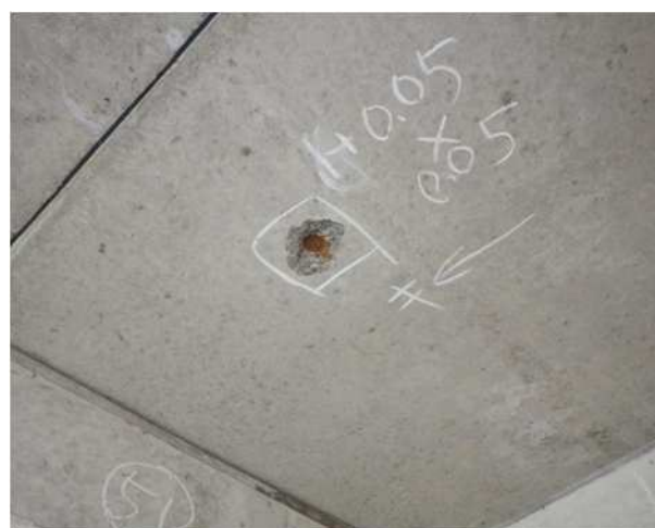
事例③頂版の鉄筋露出
