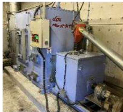
木質ペレットボイラー
