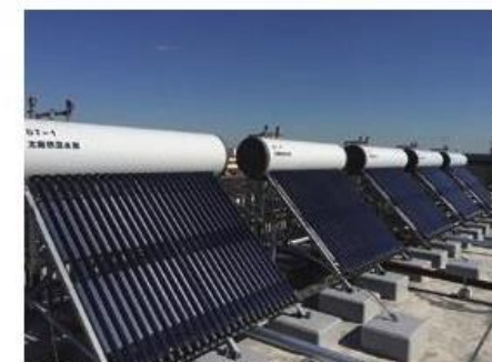
真空式太陽熱給湯システム
