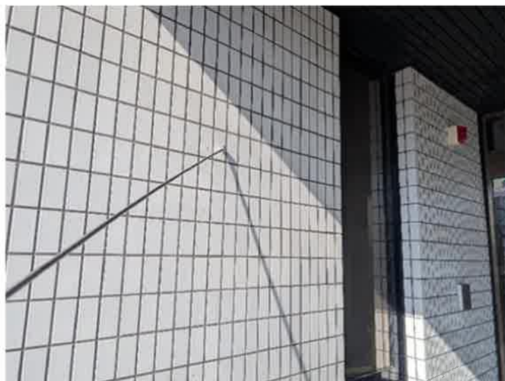
◎外壁・内壁タイル浮き
