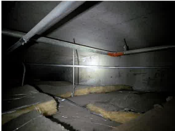
天井裏一部コンクリート落下おそれ
