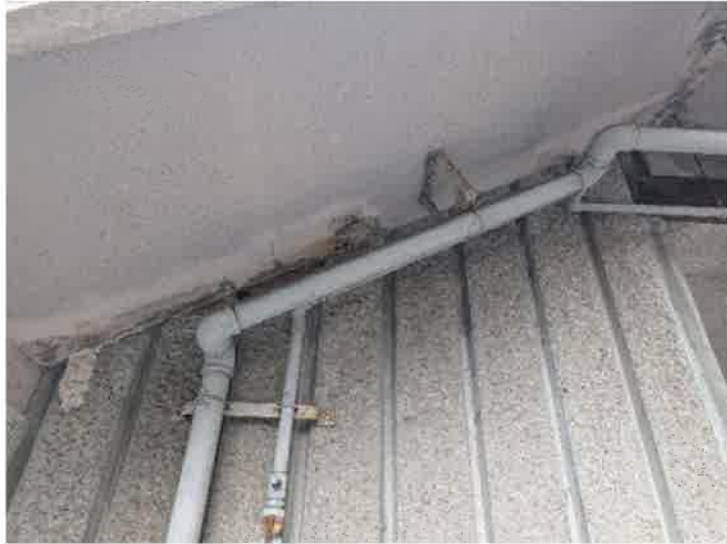
階段・軒裏一部コンクリート落下おそれ
