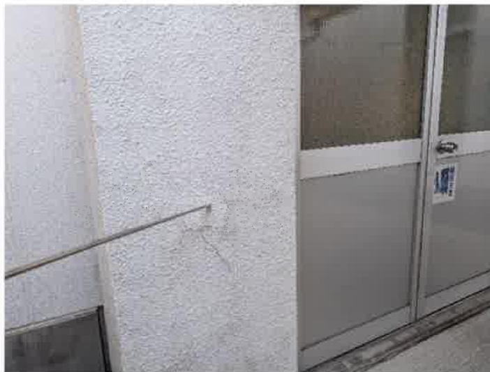
◎外壁クラック・モルタル浮き
