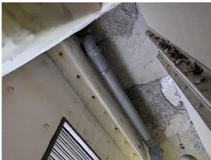
◎天井吹付材剥離
