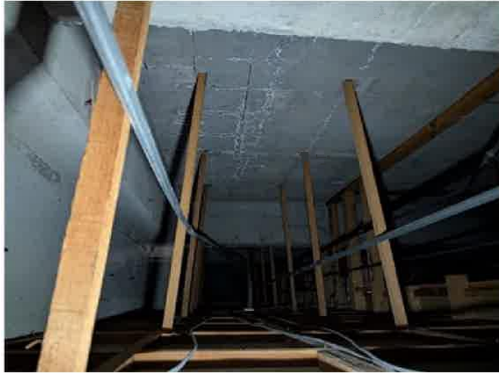
天井裏・軒裏一部はがれ・亀裂あり
