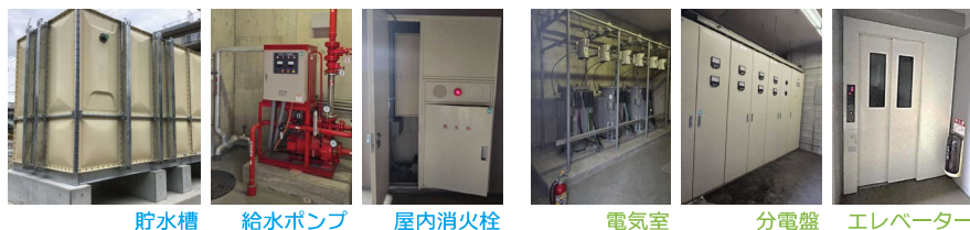
貯水槽 給水ポンプ 屋内消火栓 電気室 分電盤 エレベーター
