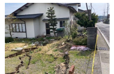
庭の亀裂被害
