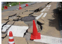
マンホールの浮上り被害
