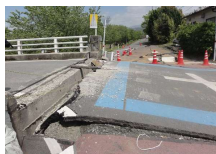
橋梁と道路の段差被害
