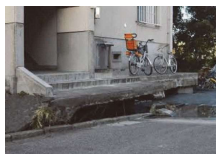
建物周辺地盤の沈下被害 (浦安市)
