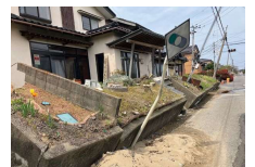
道路の噴砂と家屋被害
