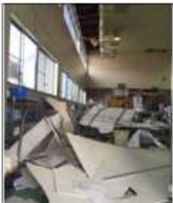
⑤ 天井、照明器具が破損
