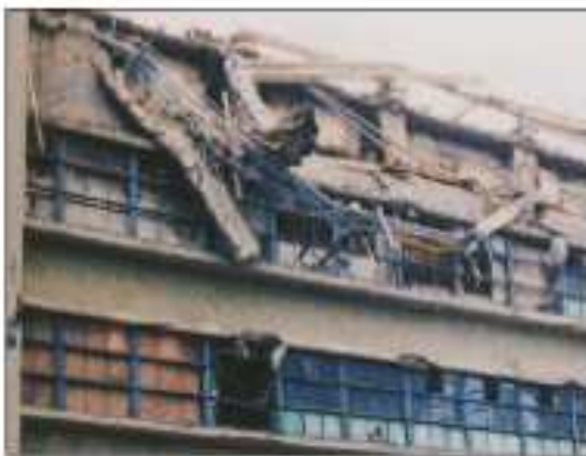
⑤ 屋根材、看板、落下の恐れ
