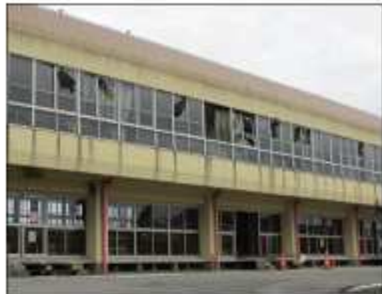
⑥ 窓ガラスが破損
