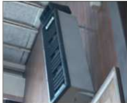
④ 建具等が破損
