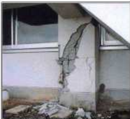
③ 建物の基礎が破損
