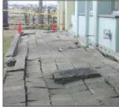
② 建物周辺に地盤沈下等が発生
