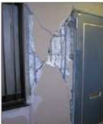
③ コンクリート壁等が破損
