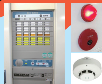
自動火災報知設備
