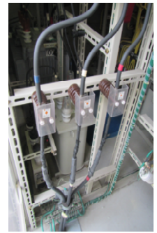
高圧受電盤内部 ケーブル引き込み点
