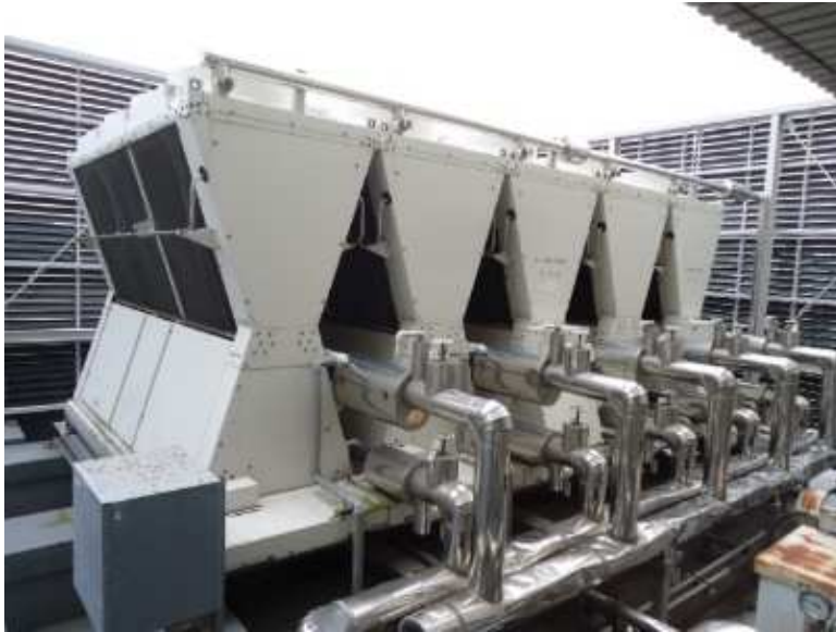
■空冷チラー現場写真（中央図書館 3 階室外機廻り）
